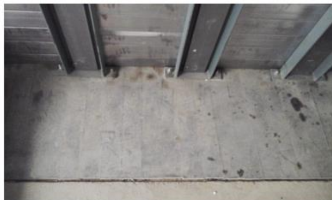
c- Plomb sous la structure métallique
